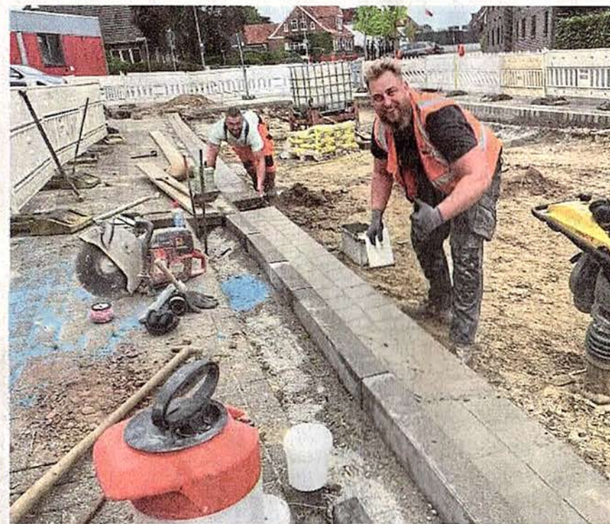
Einschlämmen der Wegeseitenränder. Für die Bauarbeiter ist das leicht bewölkte Wetter ideal.
